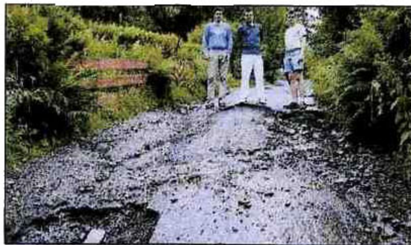
Slik ser det ut midt i Seterveien. Om vinteren har det vært dager da posten har måttet hoppe over Kjetil Ryghs (i midten) kasse. Rygh bor i toppen av Seterveien. Til venstre for ham står postens distribusjonsleder André Meldre Bilet og på høyre side Asbjørn Johannessen.
